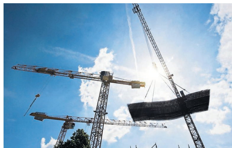
Im vorliegenden Fall konnte der Nachunternehmer, der die Betonstahl-Verlegearbeiten ausführen sollte, die nötige Markterfahrung nicht vorweisen. FOTO: DPA
